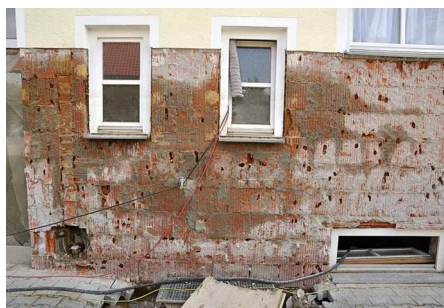
Abb. 3: Heizöl-Verfärbungen auf dem Ziegelmauerwerk
