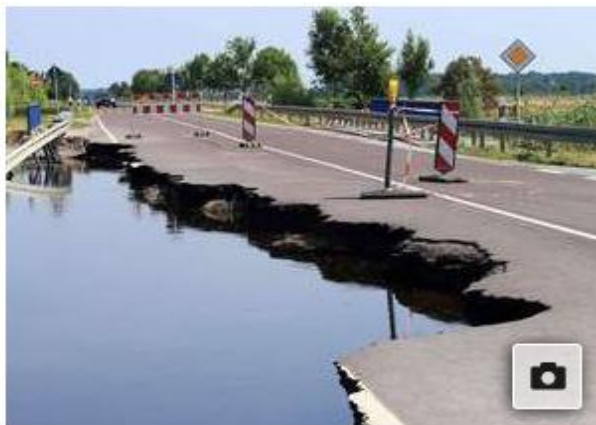
Das Hochwasser geht, der Schaden bleibt. Wie hier auf der Bundesstraße 188 bei Kabelitz (Sachsen-Anhalt). - FOTO: DPA
