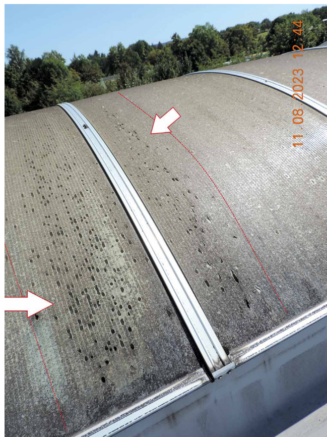
Abb. 4: Erhöhtes Schadensbild an den Fixierungsbereichen (© ILS-Bau-Consulting)
